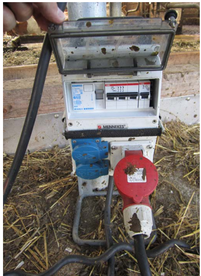
Abb. 12-3 Elektrokleinverteiler mit eingebautem Fehlerstrom- und Leitungsschutzschalter
